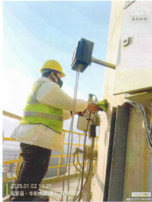
DA144 窑头排气筒采样口◎6
