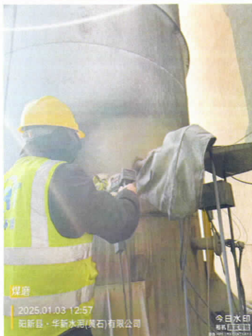
DA149 煤磨废气排气筒采样口◎9
