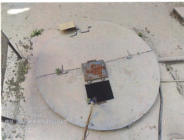
RDF 地下水 1#地下水检测点位
