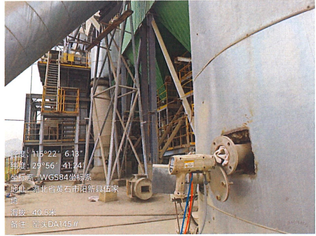
1#水泥磨辊压机排放口 DA145# 烟气在线比对检测点位
